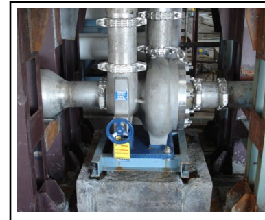
la instalación t retro a una potencia estación en la India
