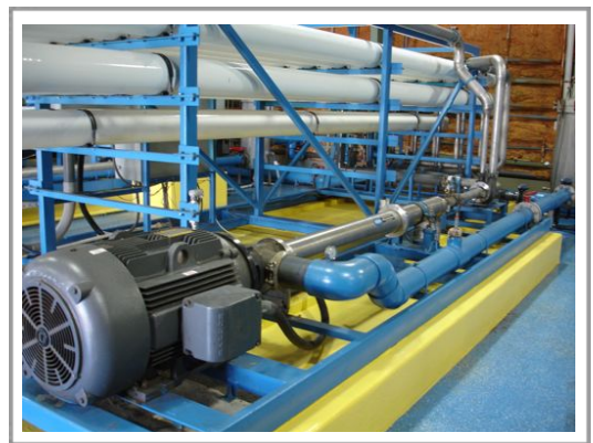
MSS y HPB en la placa de base común
